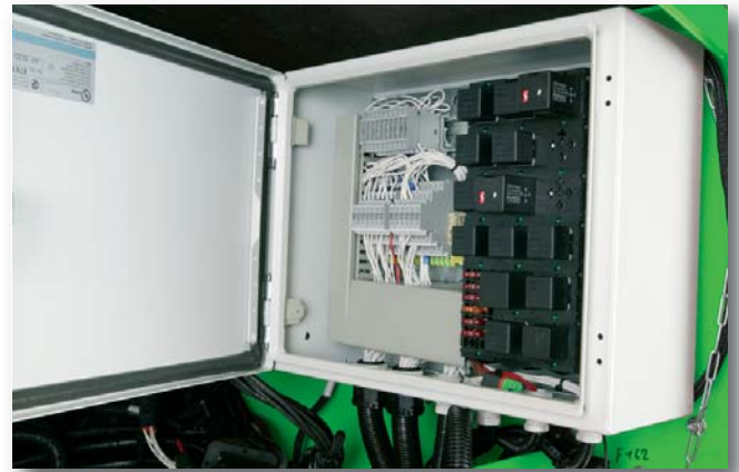
Übersichtlicher Elektroverteiler mit klarer und deutlicher Beschriftung – leichte und schnelle Fehlerdiagnose Clearly organised electrical distribution with distinct labeling - easy and quick trouble shooting
